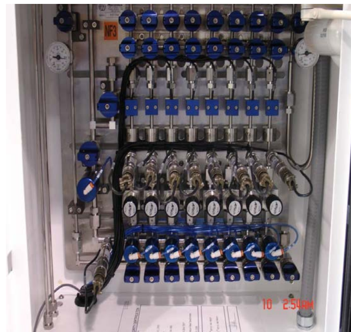
Газовые шкафы (Norcimbus)
