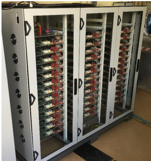
Высоковольтный источник питания на стенде.
